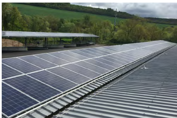
Déchetterie intercommunale du Bassin de Pompey – panneaux solaires pour autoconsommation d'énergie solaire
