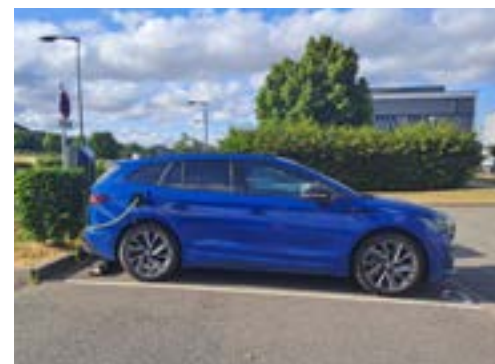
Borne de recharge à l'Espace multi-services
