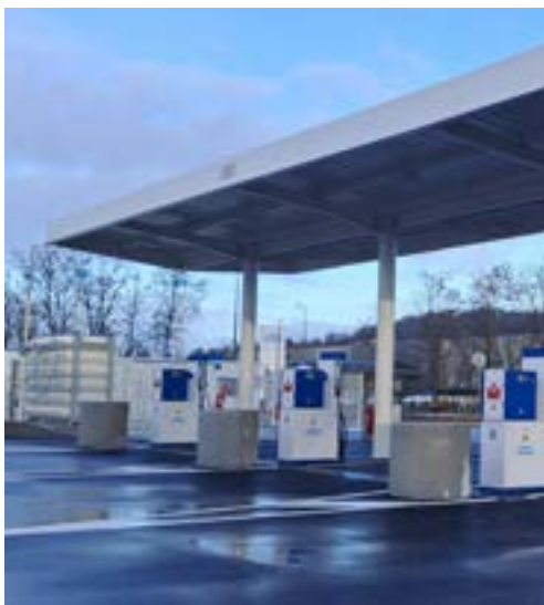
Station BioGNC et IRVE d'Engie Solutions, Rue André Ampère à Champigneulle (54)
